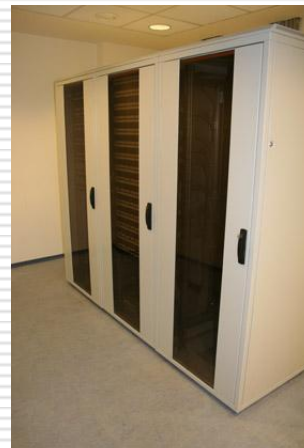
19" шкафы в серверной
